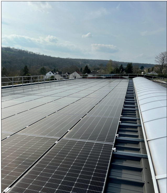
414 panneaux photovoltaïques ont été installés sur une surface de 800 m 2 pour une puissance de 395 WC.
