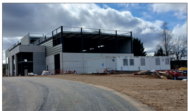
Les travaux de construction du nouveau site de recyclage de ferrailles de Galloo, dans les Ardennes, vont bon train.
