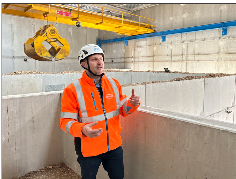
Environ 500 camions de 25 tonnes alimentent la chaufferie en bois local chaque année, souligne Sylvain Geeraerts, responsable du département d'exploitation ENGIE Solutions.
